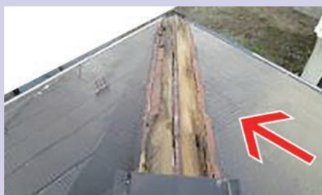
台風による隅棟の破損 出典：国土技術政策総合研究所資料
