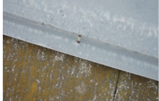
留付け釘の浮き
