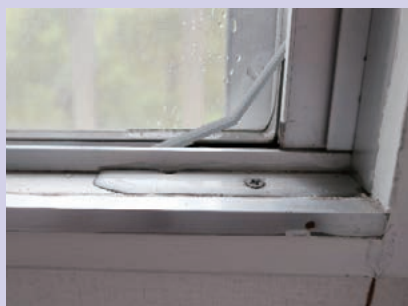
気密材・ガラス押えの劣化を放置したためガラス押えがはずれて漏水
