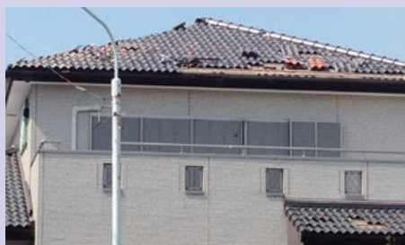
台風による瓦のめくれ 出典：国土技術政策総合研究所資料
