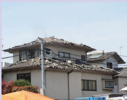
地震により瓦がずれて落下 出典：公益社団法人土木学会
