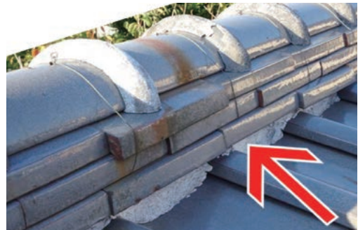
緊結銅線の劣化
